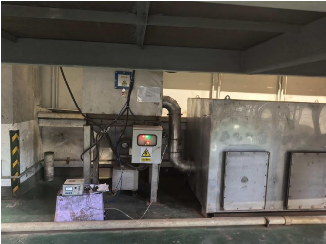
喷雾干燥收集及布袋除尘器
