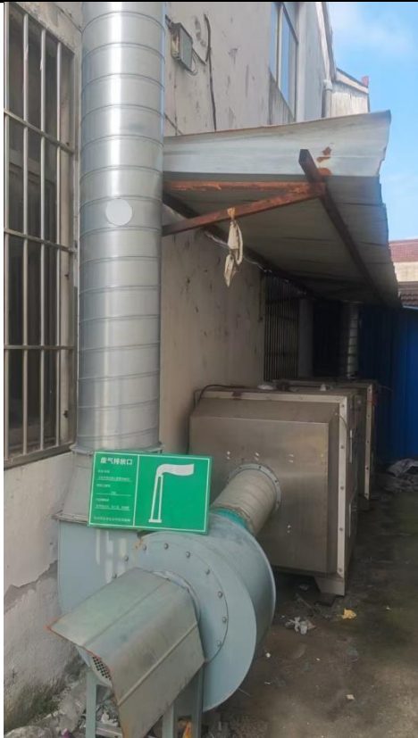
二级活性炭装置及 FQ1 排气筒
