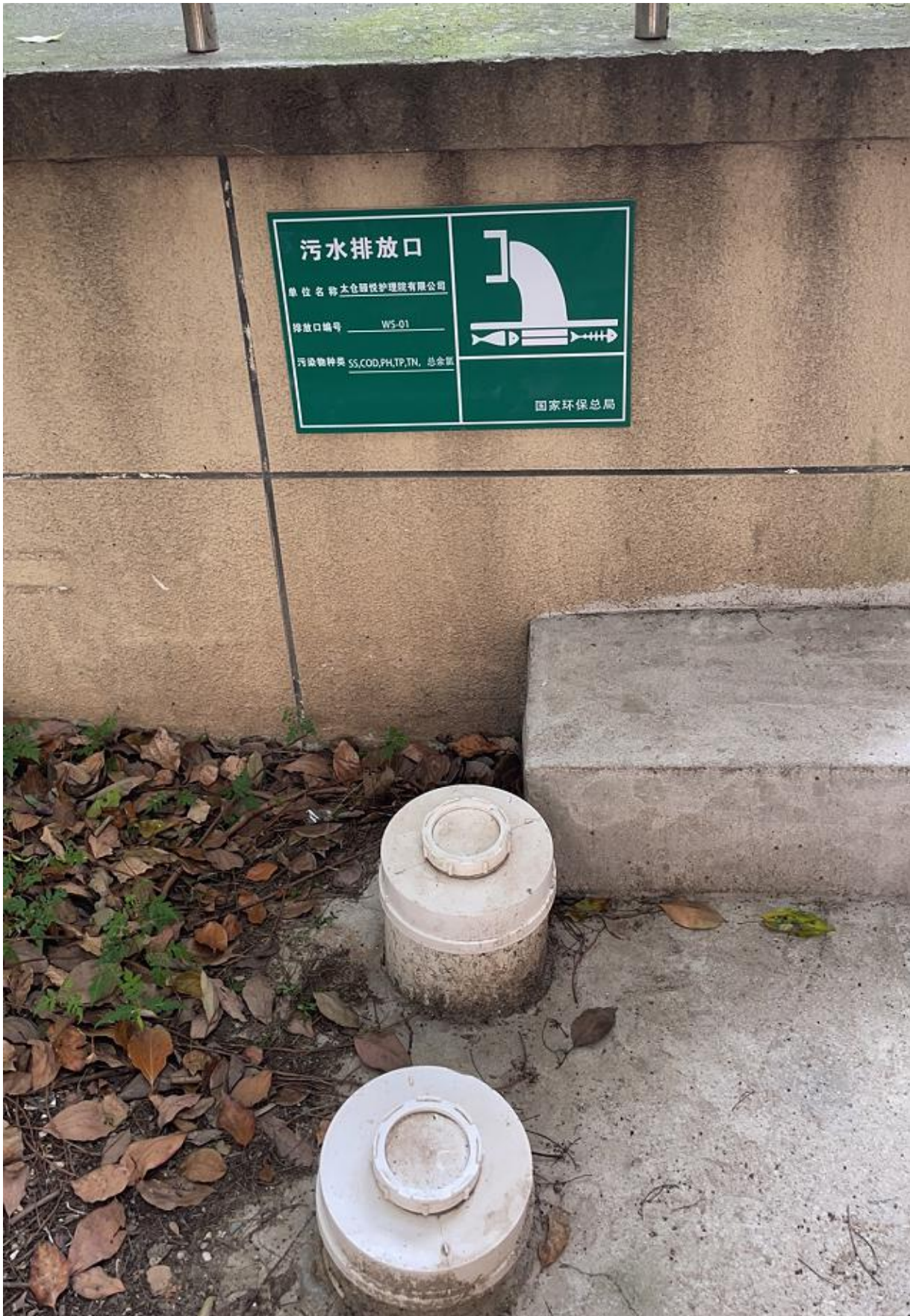
附图六：污水排放口
