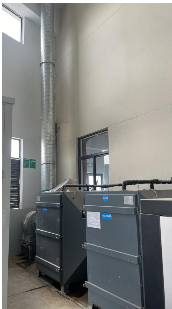
二级活性炭装置及 FQ1 排气筒
