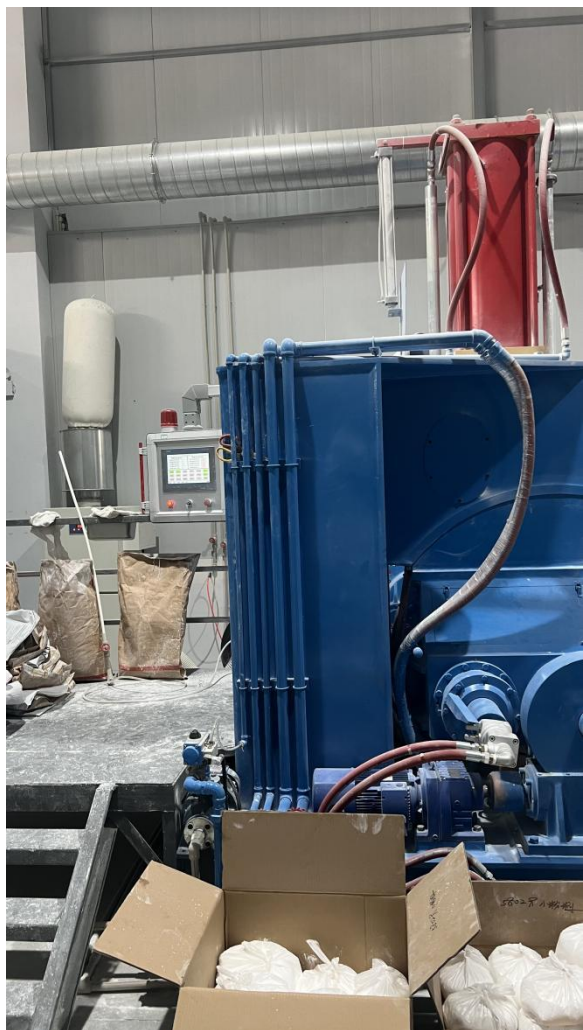
投料废气收集及 1#脉冲滤筒除尘装置
