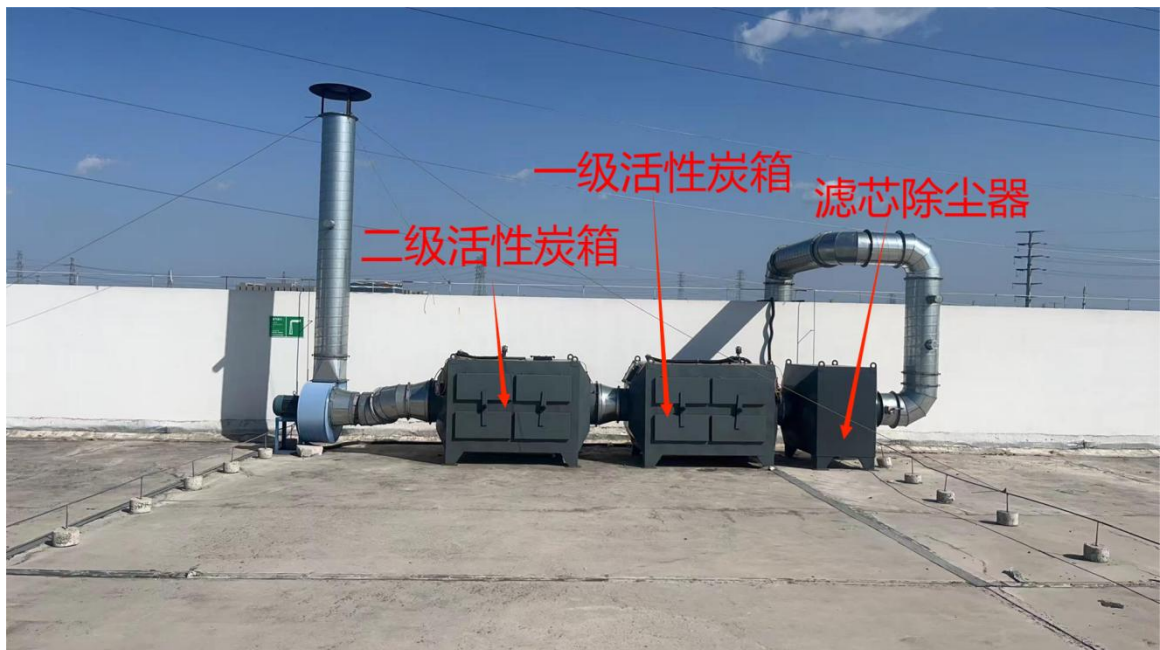
图 4-3 废气治理设施
