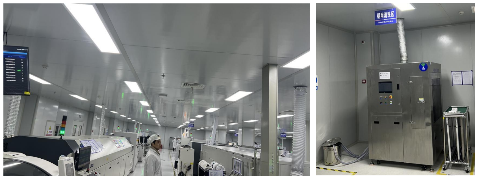
图 4-3 P1 废气车间内废气收集
