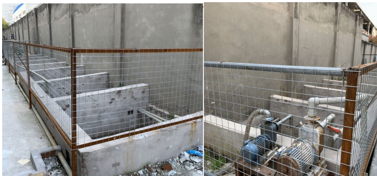
图 4.1-1 废水污染防治设施照片
