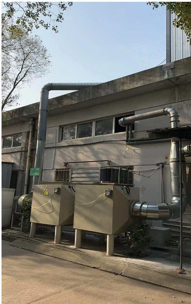
图 4-2 废气治理设施
