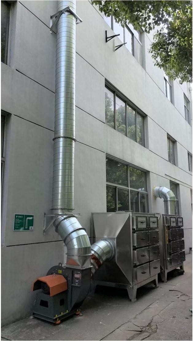
二级活性炭装置及 FQ1 排气筒
