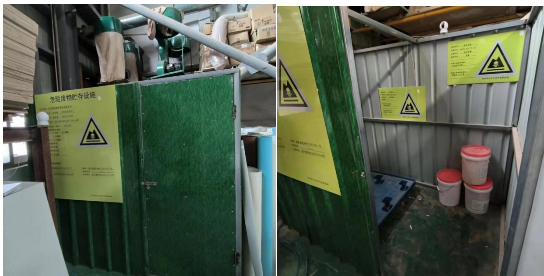
危险废物仓库
