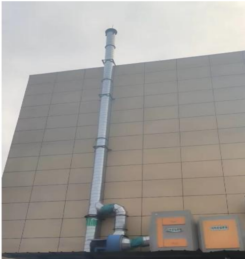
图 4-6 废气治理设施和 P1 排气筒
