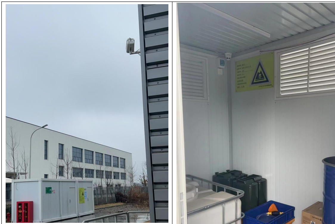
图 4-4 危废仓库内、外监控设备
